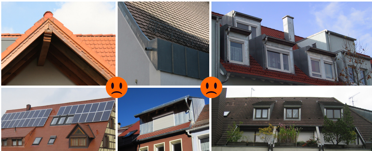
Dachmaterialien wie Blech oder Betonstein, Dachabschlüsse wie Ortgangziegel und Einblechungen, Kastengauben und Loggien stören die Dachlandschaft ebenso wie eine Überfrachtung einzelner Dächer mit verschiedenen und zu groß dimensionierten Dachaufbauten.
