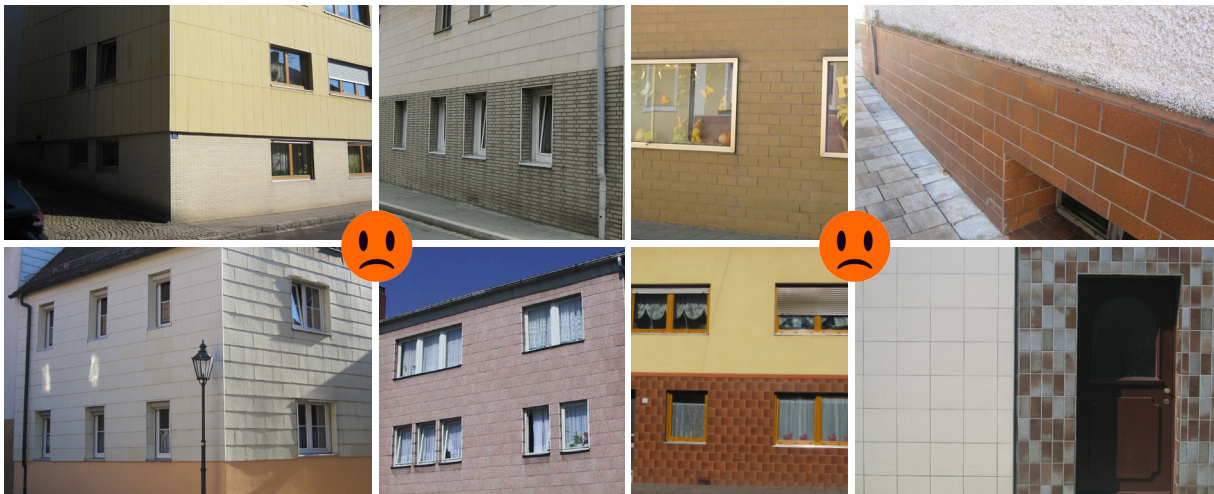
Fassadenverkleidungen aus Eternit, Kunststoff oder geflieste Fassaden verdecken die historischen Fassadenstrukturen und sind nicht förderfähig.
