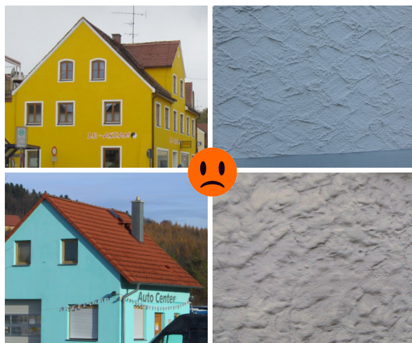
Grelle Farbgebung und moderne Putzstrukturen sind für historische Gebäude untypisch und nicht förderfähig.
